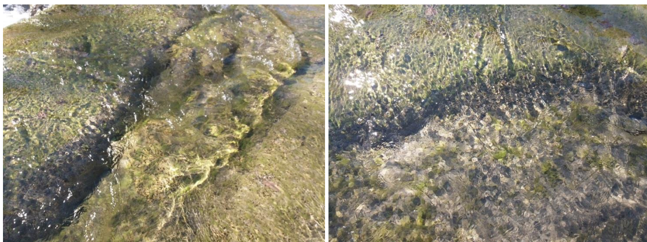
4. Absence de ferrailage
