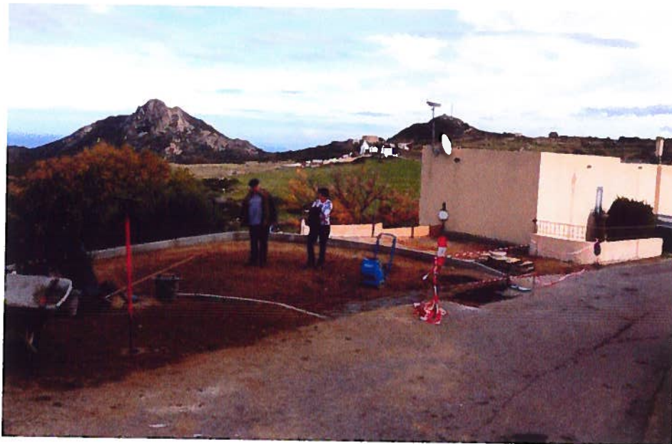
Raccord haut de la voie n°1
