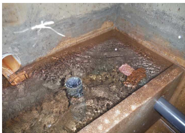
Source : G2C ingénierie, 2016. Figure 18 : Bac de réception de la Source Leduc.
