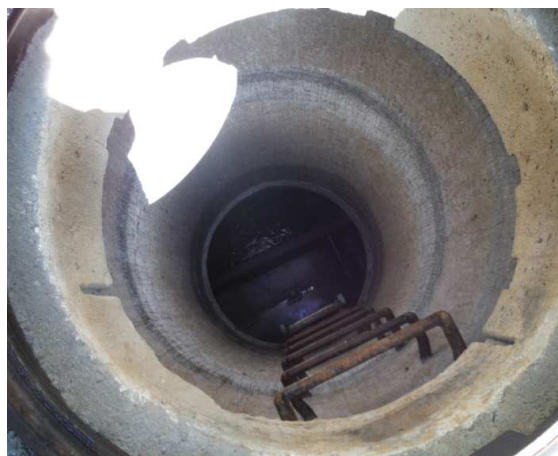
Source : G2C ingénierie, 2016. Figure 17 : Accès au captage de la Source Leduc.
