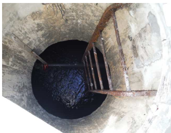
Source : G2C ingénierie, 2016. Figure 23 : Cuve du RV du Haut du Mont.
