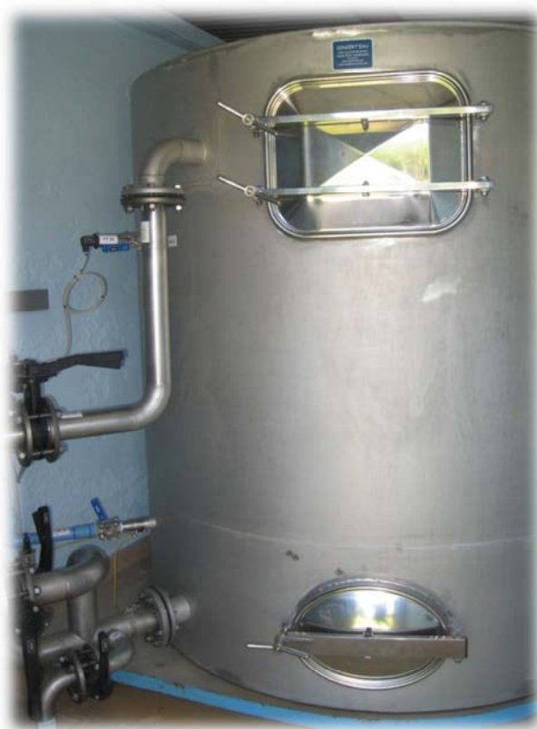
Filtre à charbon actif de l'unité de distribution d'eau à VAUCONCOURT NERVEZAIN
