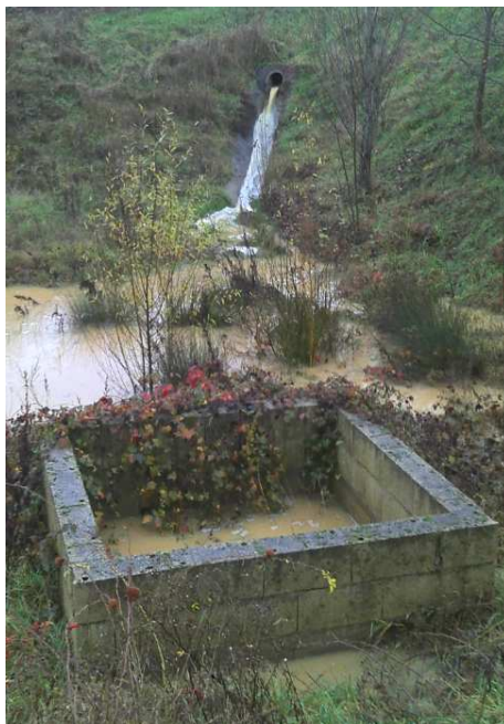
Bassin de rétention pluvial avec rejet dans réseau d'assainissement (BV SUD)
