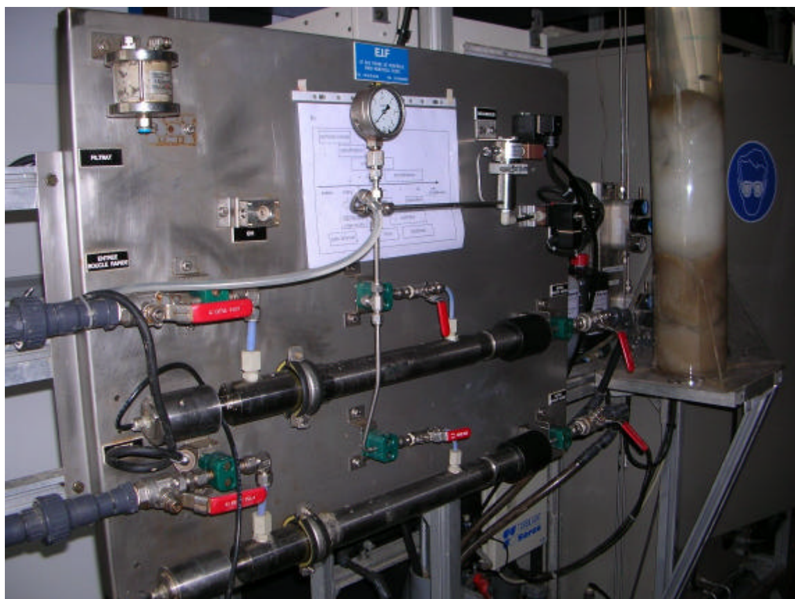
Figure 4 – Dispositif de filtration tangentielle de la station.
