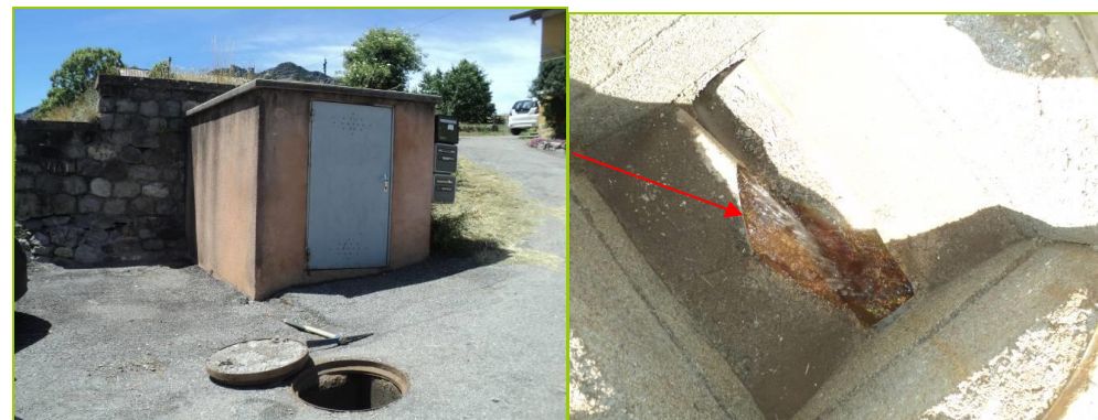
Figure 11 : Surverse du réservoir d'eau potable dans le réseau EU
