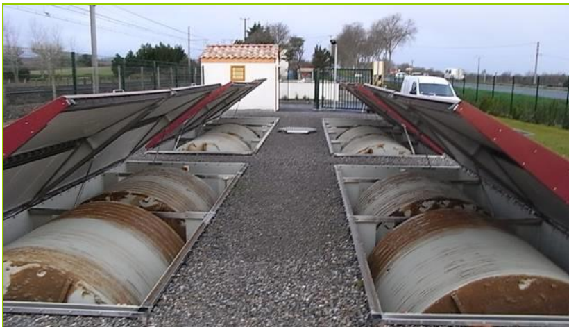
Figure 17 : Station d'épuration équipée de disques biologiques
