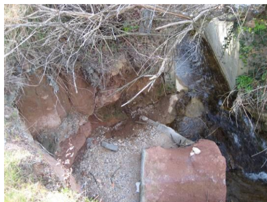
Effondrement au droit d'une prise d'eau du réseau d'irrigation SCP.
