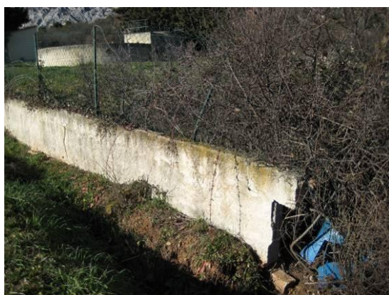
Effondrement du mur d'enceinte de la step de Puylobier
