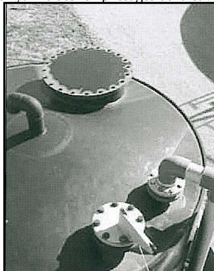
Figure 17 : Cuve de stockage du chlorure ferrique (extrait FNDAE n°22bis, « Stations d'épuration : dispositions constructives pour améliorer leur fonctionnement et faciliter leur exploitation », 2002)
