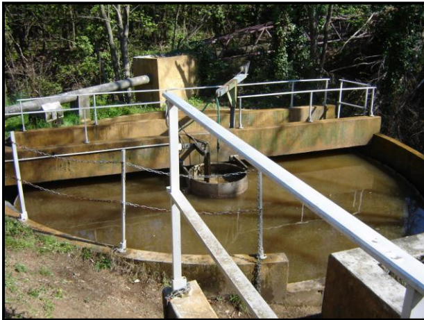
Figure 1 : STEP Thueyts : clarificateur
