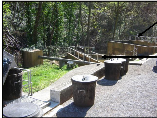
Figure 2 : STEP Thueyts : clarificateur et bassin d'aération
