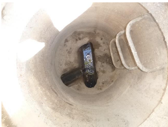
Grande Rue – présence d'eaux claires
