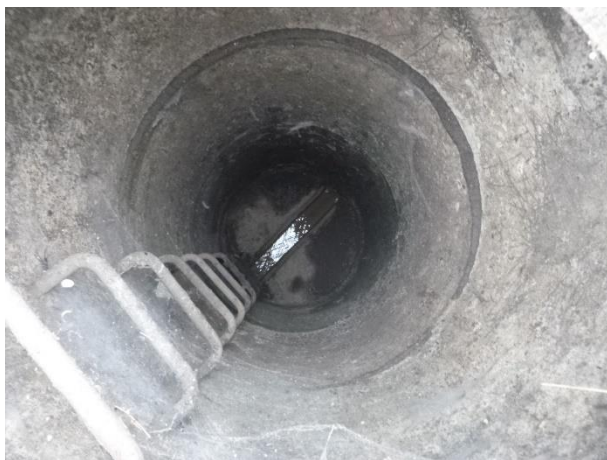
Traces de mise en charge en amont du poste de refoulement
