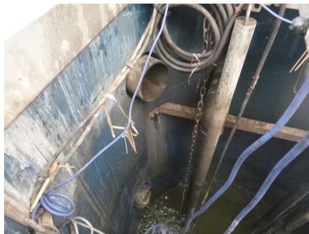
Poste de relevage et trop-plein
