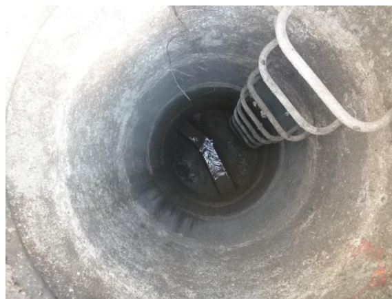
Collecteur structurant – jonction cunette/banquette non étanche
