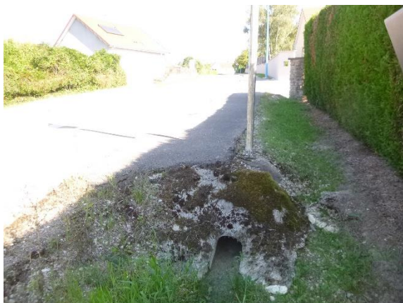
Traces d'eaux grises rue de Besançon
