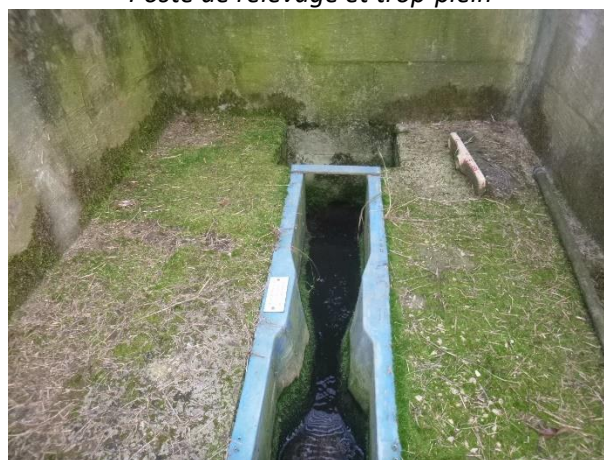
Canal de comptage des eaux traitées
