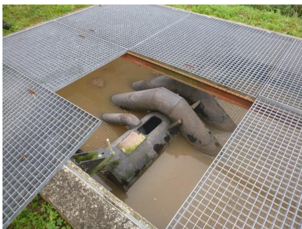
Arrivée des effluents bruts dans la bache
