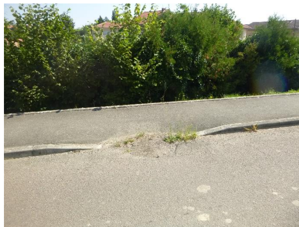
Regard de visite en bordure de rue de Besançon ayant fonction d'avaloir de chaussée
