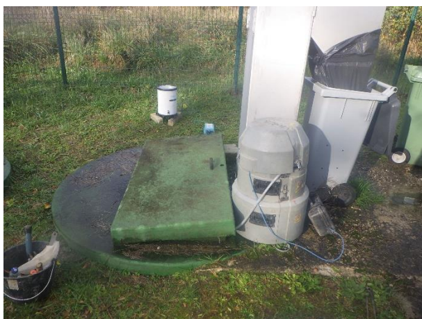
Installation du préleveur en P3 (PR STEP)
