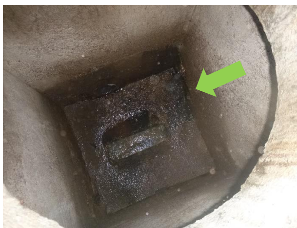
Regard de visite eaux usées n°5 - Apparition du colorant injecté dans le réseau pluvial
