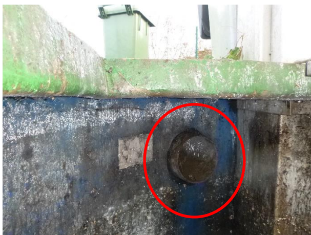
Surverse du poste
