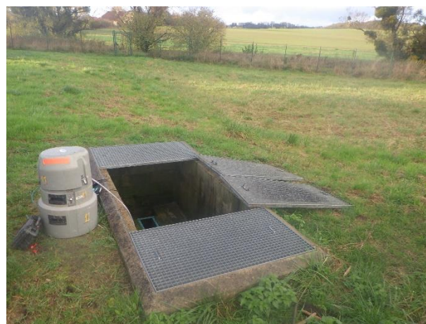
Installation du préleveur en P4 (PR STEP)
