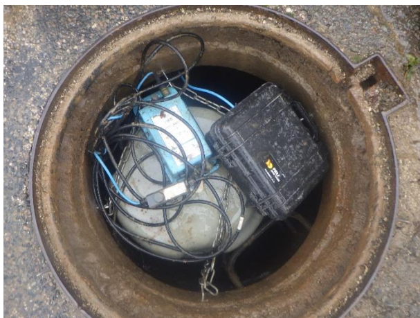
Installation du préleveur en P1 (Grande Rue)
