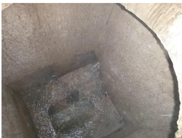
Apport d'eaux pluviales au réseau d'eaux usées (novembre 2023)
