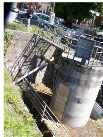
Photo 1 : Poste de relèvement du Grand Pré
