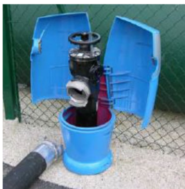
Exemple de poteau d'aspiration
