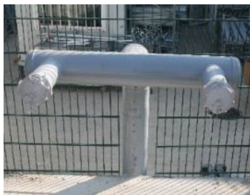
Exemple de colonne d'aspiration
