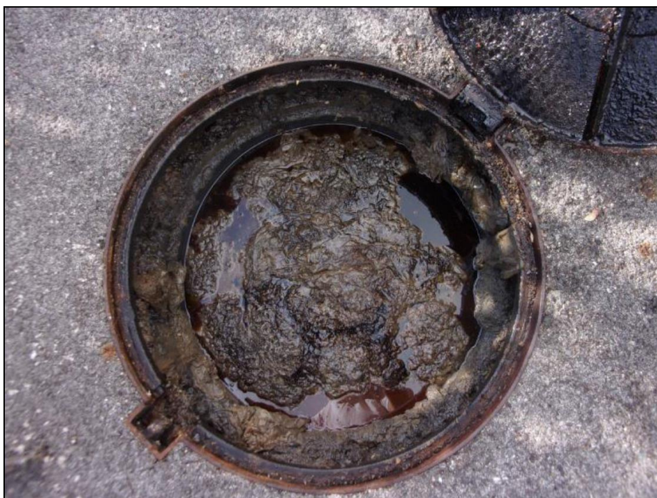
Figure 6 : Regards en charge constatés sur le réseau d'eaux usées de l'usine FRAGWORLD
