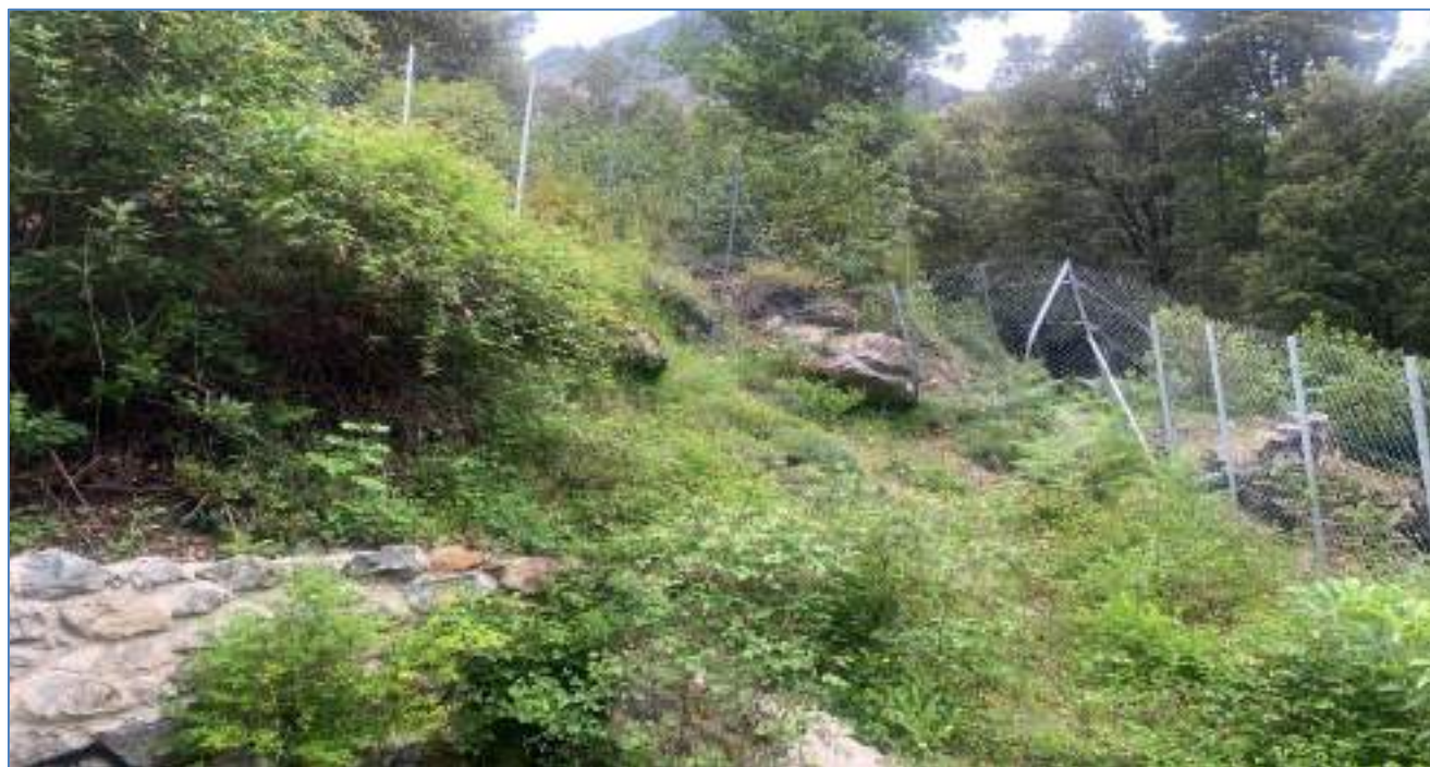
Photographie 5 : Chute d'un bloc de roche sur la clôture
