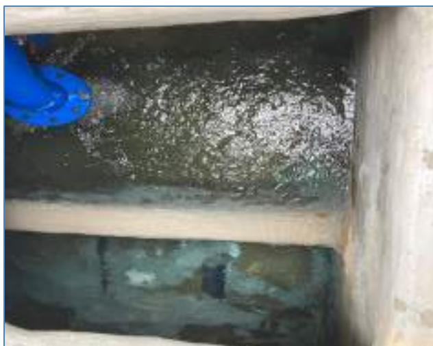
Photographie 3 : Regard de décantation
