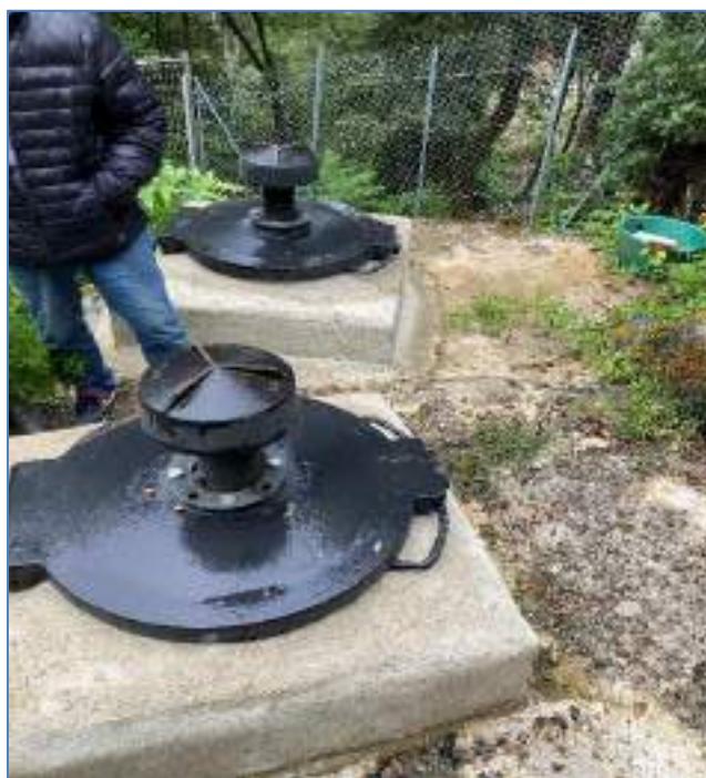
Photographie 1 : Regard de collecte des eaux captées
