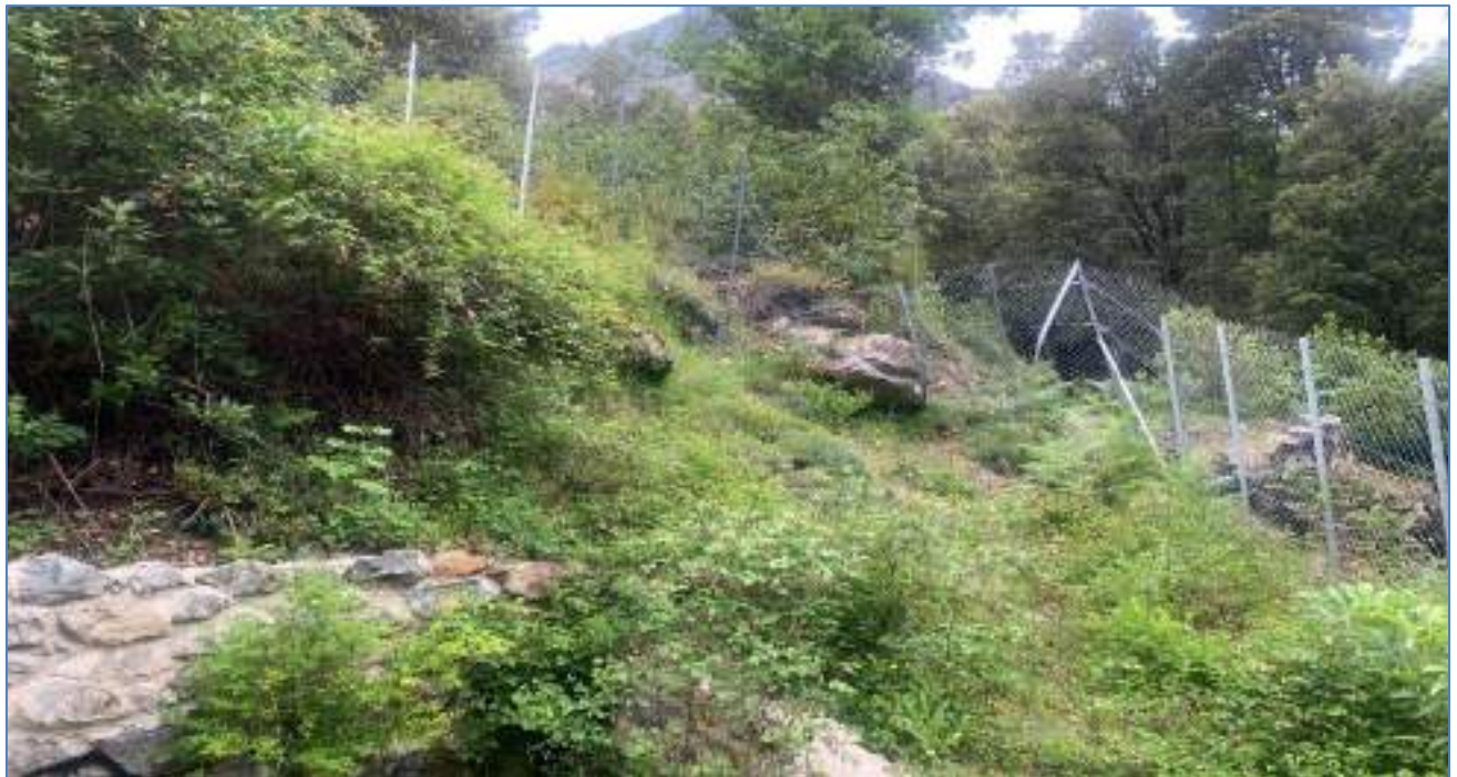
Photographie 5 : Chute d'un bloc de roche sur la clôture
