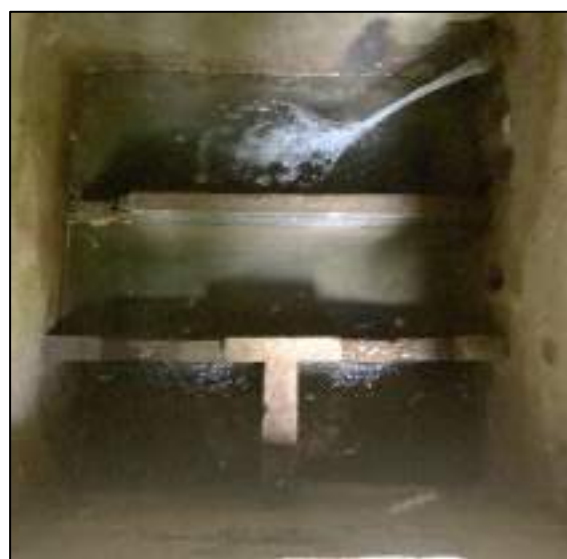
Photographie 7 : Ouvrage de dessablage et de partage
