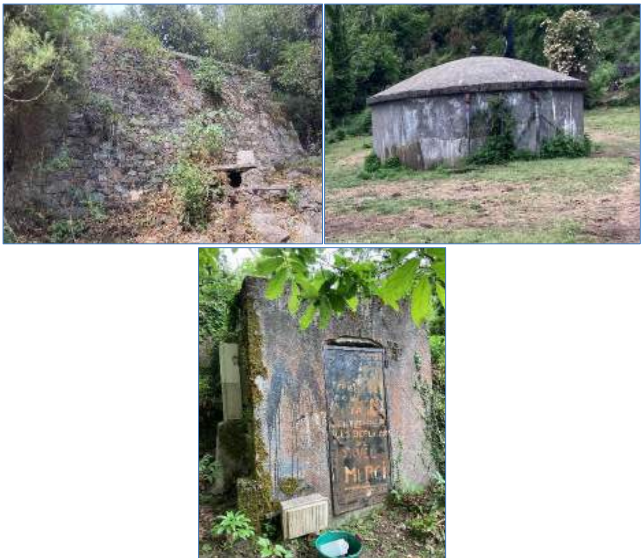
Photographies 10 : Réservoirs R1, R2 et R3 de la commune de Campana
