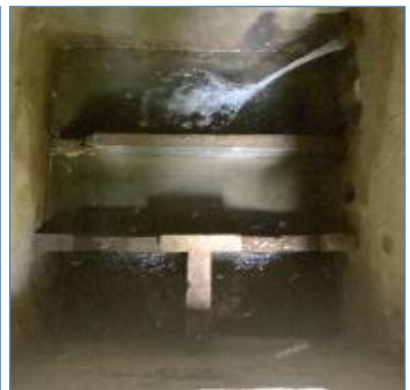
Photographie 7 : Ouvrage de dessablage et de partage
