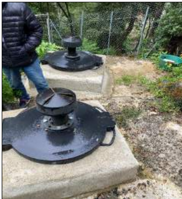
Photographie 1 : Regard de collecte des eaux captées
