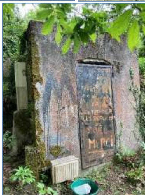
Photographies 10 : Réservoirs R1, R2 et R3 de la commune de Campana
