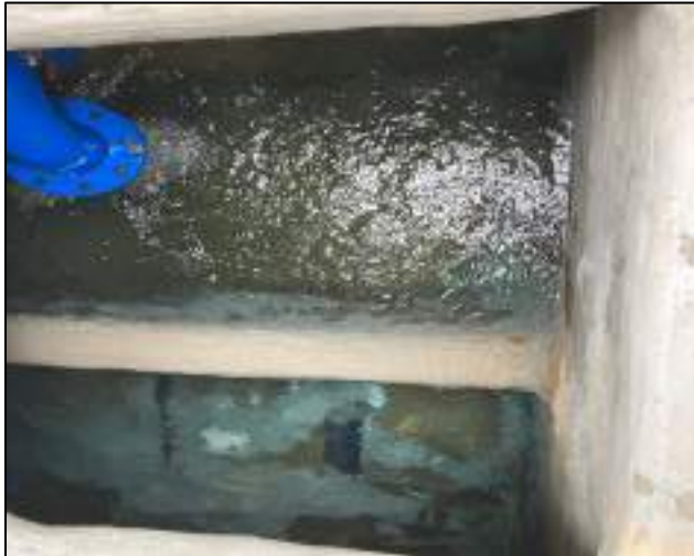
Photographie 3 : Regard de décantation
