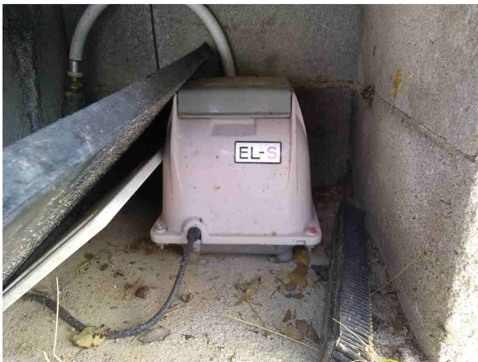
Photo 8 : Compresseur assurant le bullage pour le déshuileur
