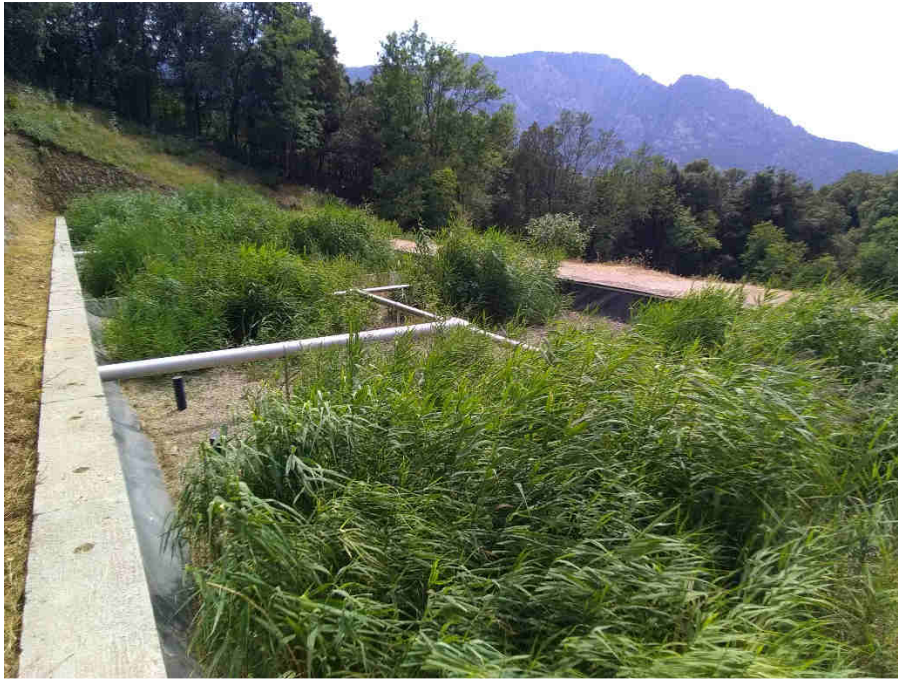
Photo 9 : 1 er étage de filtres
