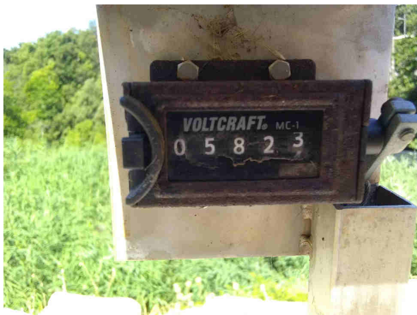
Photo 13 : Compteur de bâchées de la chasse du 2 nd étage.
