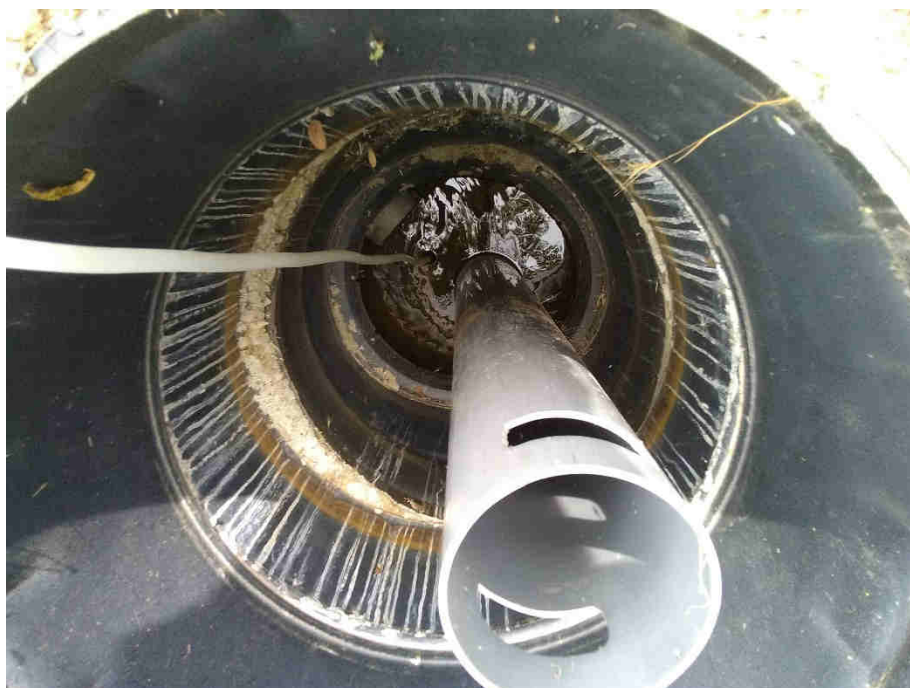
Photo 14 : Regard de prélèvement en sortie du 2 nd étage.
