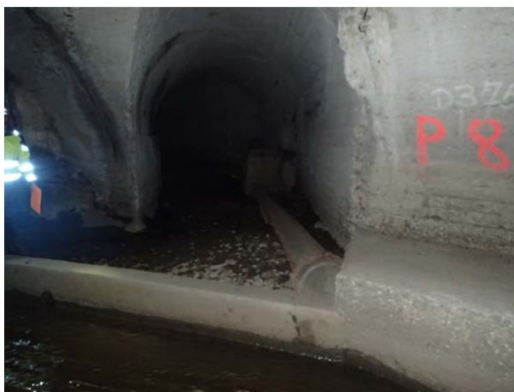
Figure 3-7 : Amorce de l'antenne Ø400 enterrée dans la galerie secondaire rive droite du Gier
