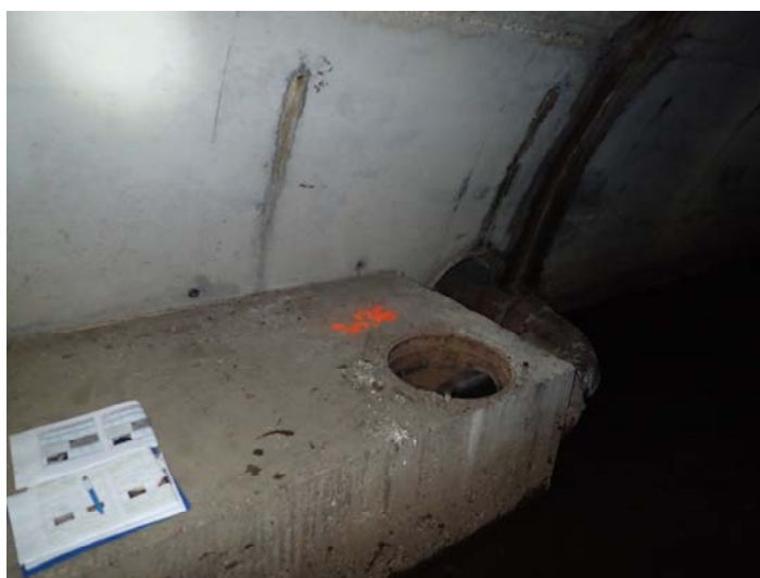
Figure 4-1 : Tampon manquant (DO 36)
