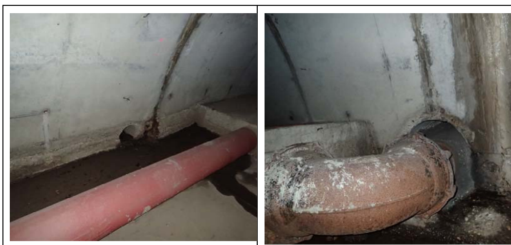
Figure 3-9 : Collecteur SEM Ø300 dans la galerie du Gier sous le cours du 11 novembre
